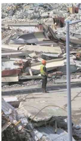
Ein Arbeiter steht mitten zwischen den riesigen Trümmern des Schornsteins.
